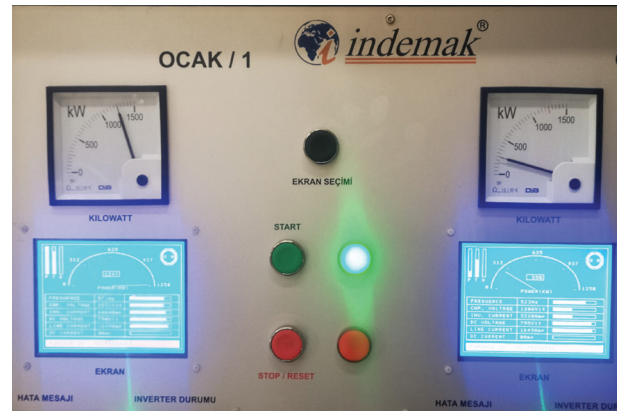
Power Unit Control Panel / Силовой Блок Панель Управления
